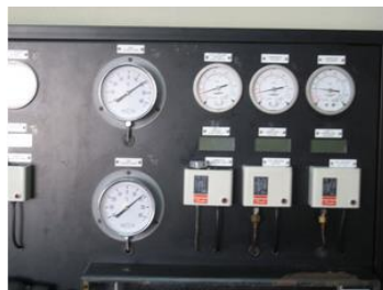
Técnico de Frio e Climatização
